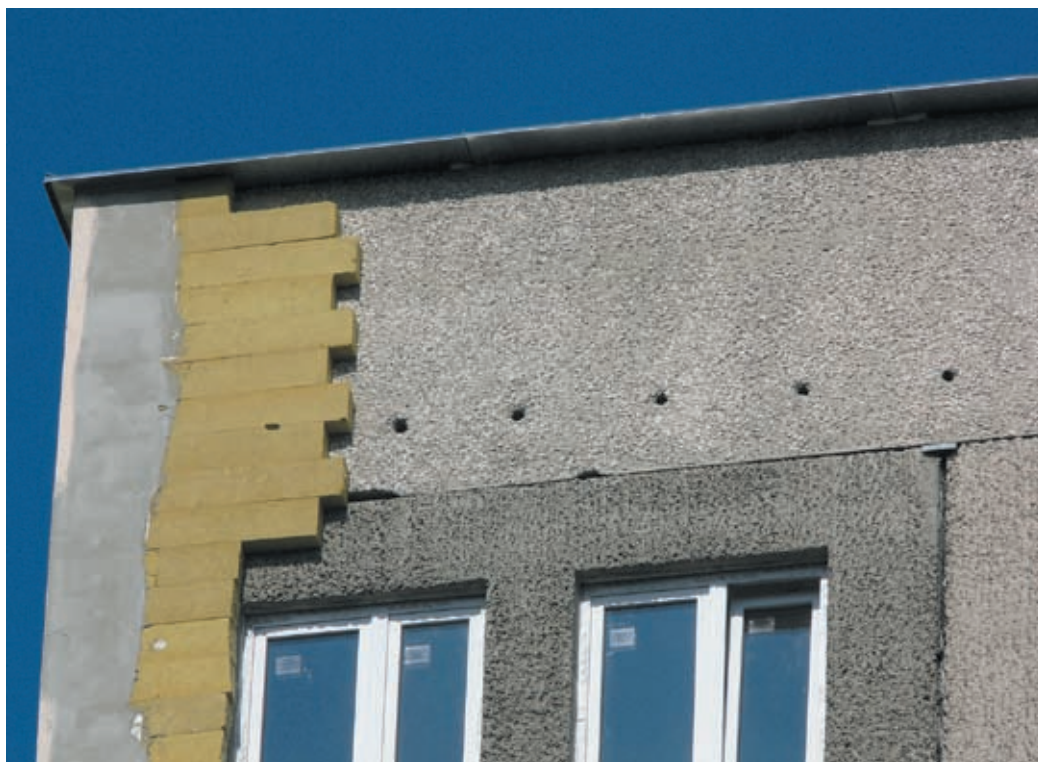
Fot. 46. Otwory wentylacyjne w budynku z wielkiej płyty przed ociepleniem budynku (fot. K. Walasz).
